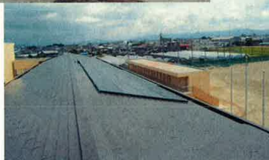
図1 太陽光発電の導入例 (上:豊橋市立羽田中学校、 中:豊橋市立豊城中学校、下:豊橋市立吉田方中学校)
